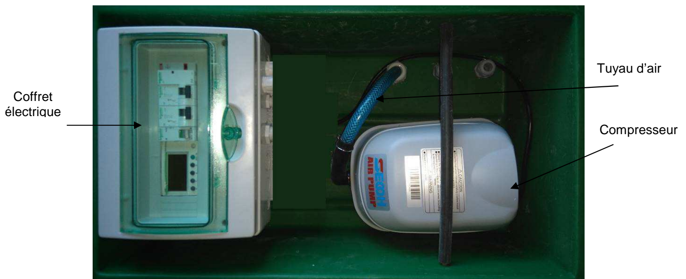
Photos de l'armoire de commande
