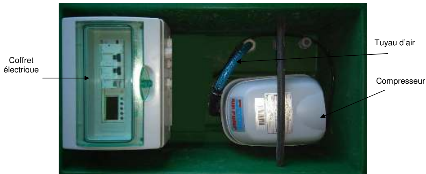
Photos de l'armoire de commande
